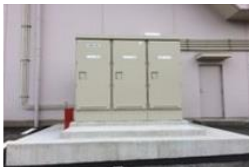
図 2-5 蓄電池設置の様子 （保健福祉会館）
